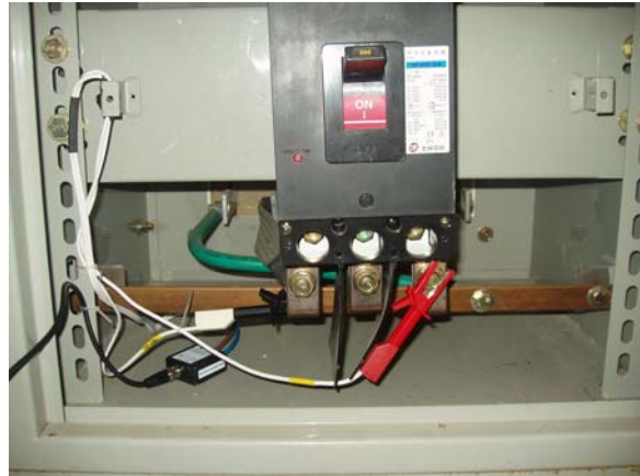
(地下室一樓電力機房 PLC Coupler 架設)
